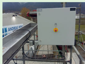
Vibrorinne mit Schaltschrank
