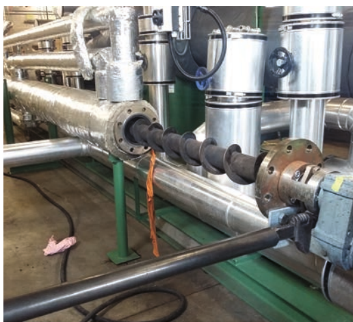
Fig. 4 Aufheizung des Schlammes vor dem Reaktor.
